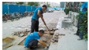
雨水过多地面塌陷 及时维修恢复平整
